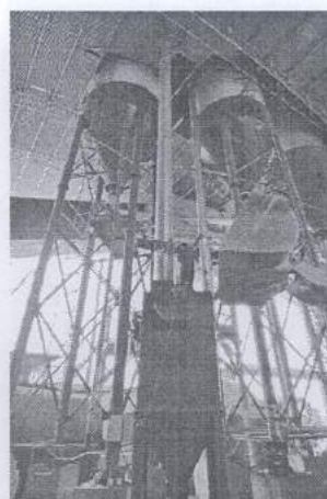
商混水泥筒仓工序布袋除尘器+排气筒
